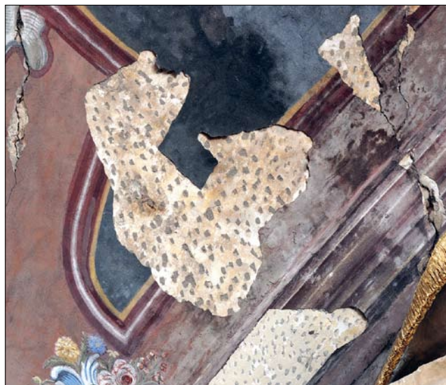
Obr. 4: Libědice, kostel sv. Víta, pekovaná podkladová omítka je patrná rovněž na opadlých plochách nástupní malby (foto Z. Neustupný, 2025).
